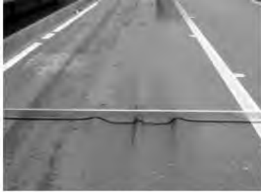
Figura 1. Fenómeno del ahuellamiento. Vía Calle 80, Bogotá, Colombia.
