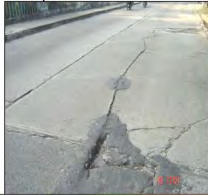
Fotografía 6. Vista típica de las grietas en bloque
