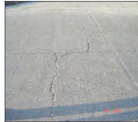
Fotografía 4. Vista típica de una Grieta Transversal.
