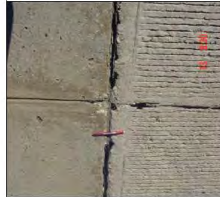
Fotografía 9. Vista típica de un deterioro de sello.
