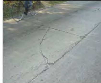
Fotografía 2. Vista típica de una grieta de esquina
